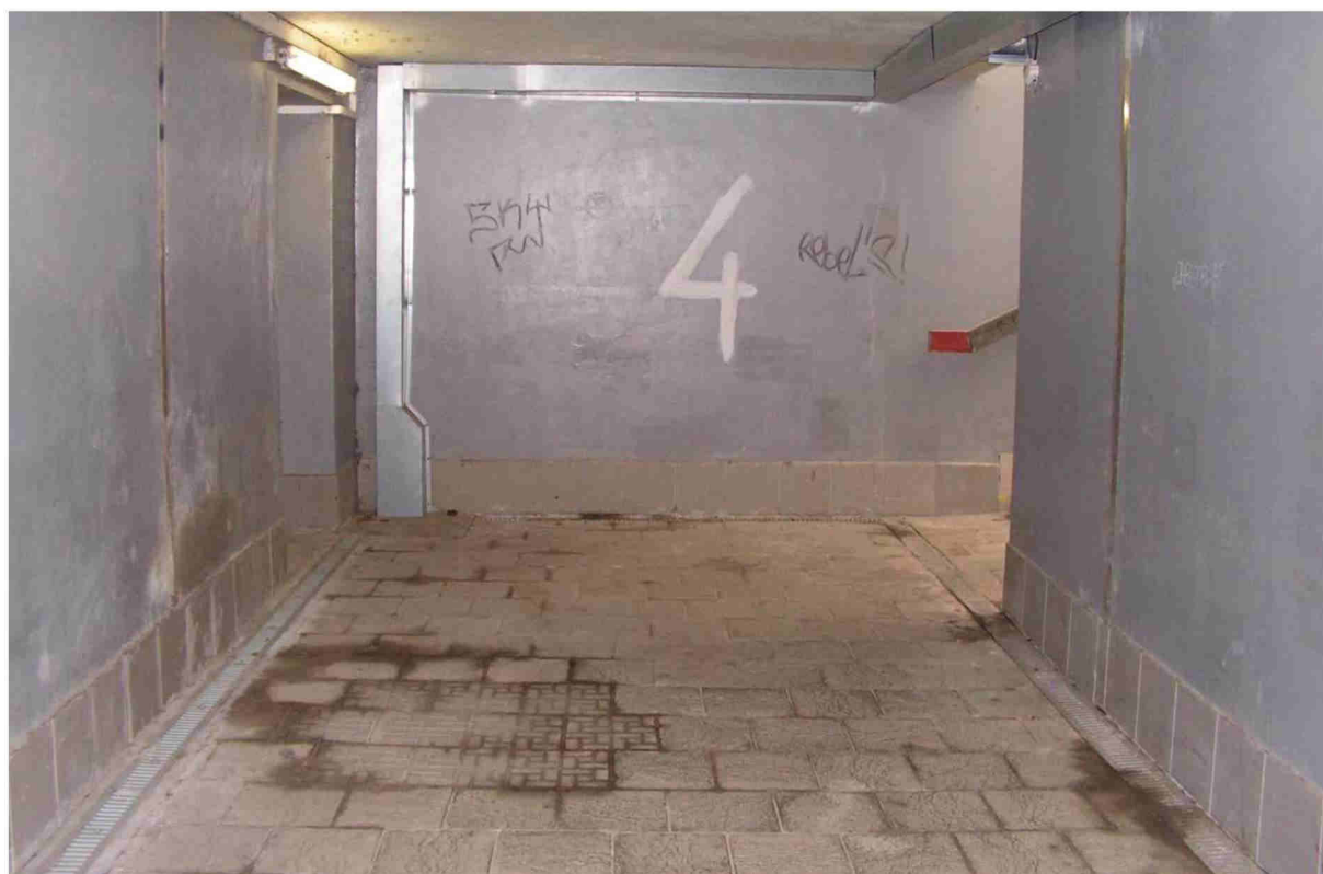
Zaječí, podlaha, stěny (také dilatační spáry)
