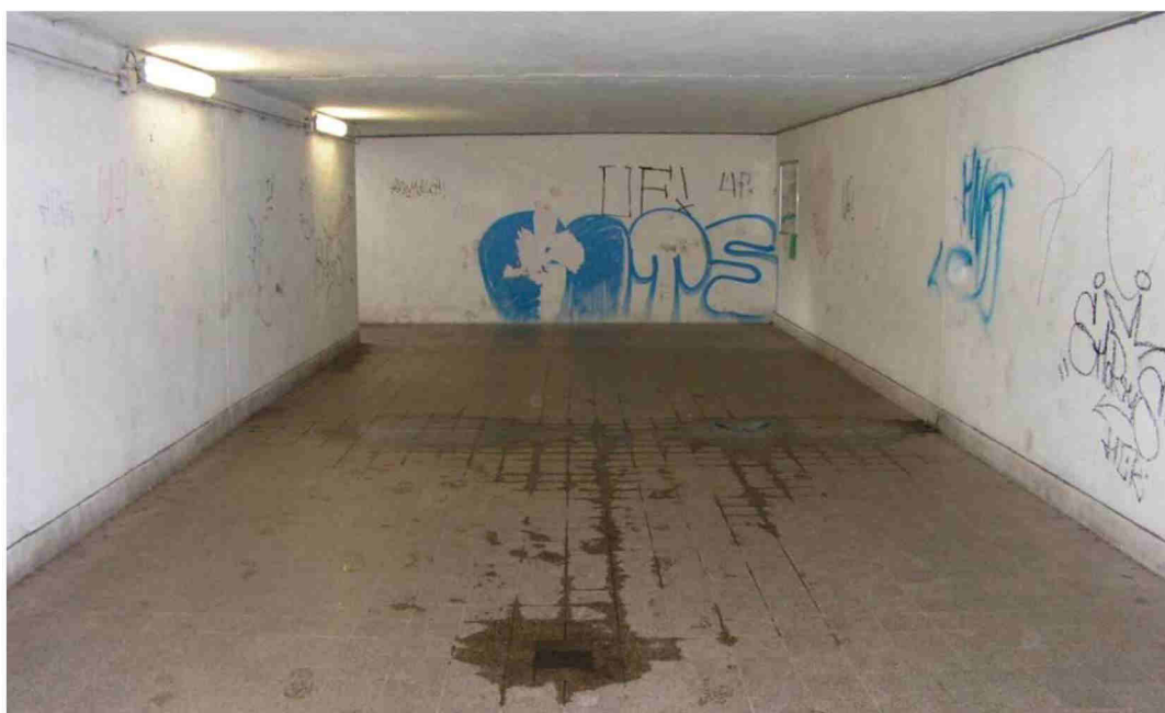
Tišnov, voda pod tekoucí dilatační spárou.
