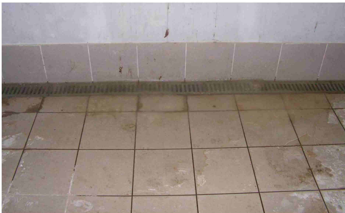
Moravská Nová Ves, průsak podlahou
