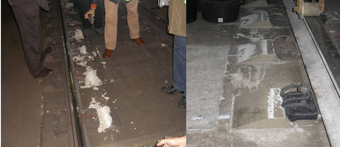
Obr. 3 Vykojení v tunelu Melk, stav před a po opravných pracích (fotodokumentace f. PORR)
