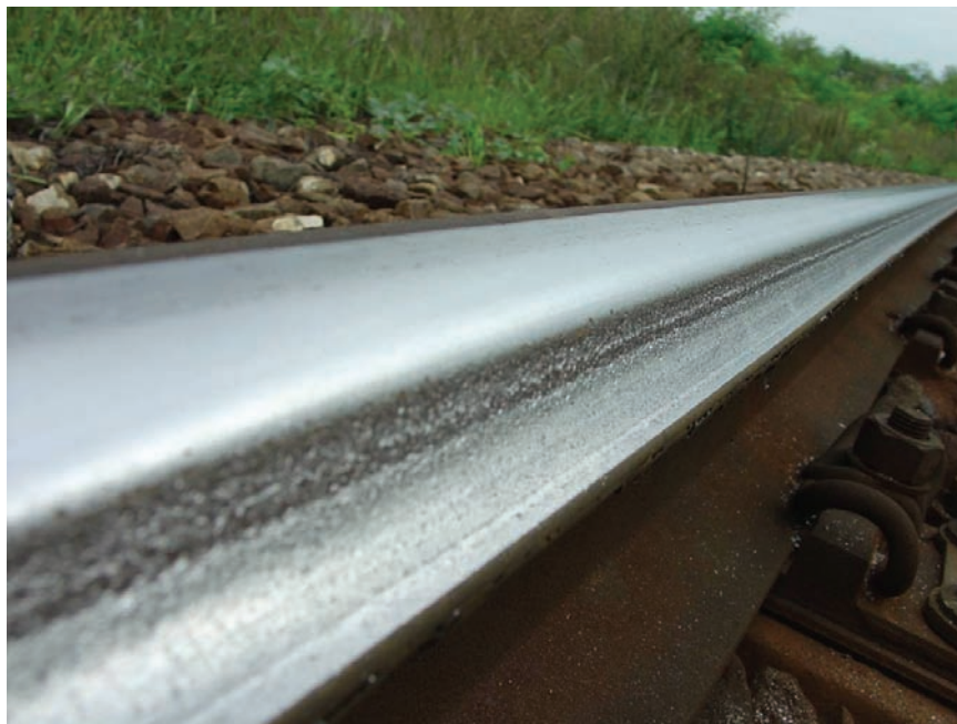
Obr. 1 Kolejnice opotřebená bočním ojetím
