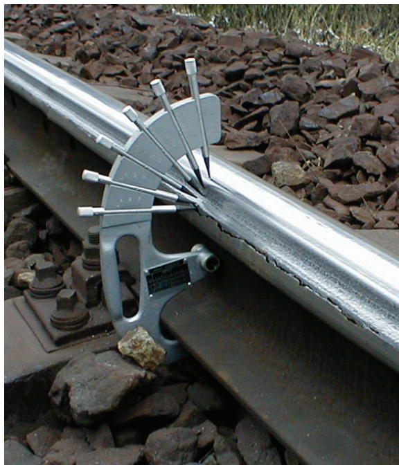
Obr. 1 Opotřebení kolejnic je v úseku významné, vyžaduje pečlivé sledování. (TÚ Ústí nad Orlicí – Brandýs nad Orlicí km 262,265, červenec 2005)
