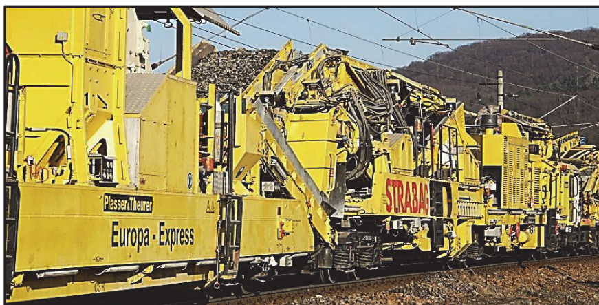
Obr. 2 - Pohled na stroj RM 900 VB při pracovním nasazení v mezistaničním úseku Havlíčkův Brod - Okrouhlice
