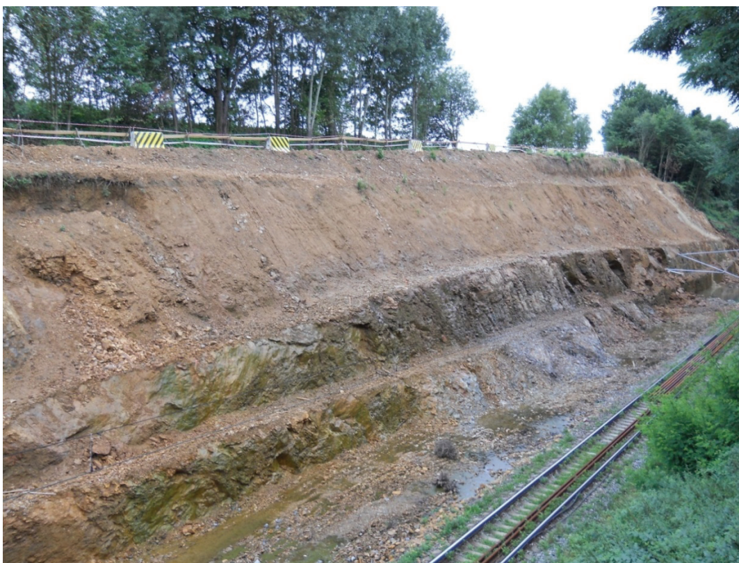
Obr. 2 Výchozí stav před sanací Střelítovského zářezu, na snímku jsou zřejmé sesuvy svahů a značný přítok vody i v suchém období
