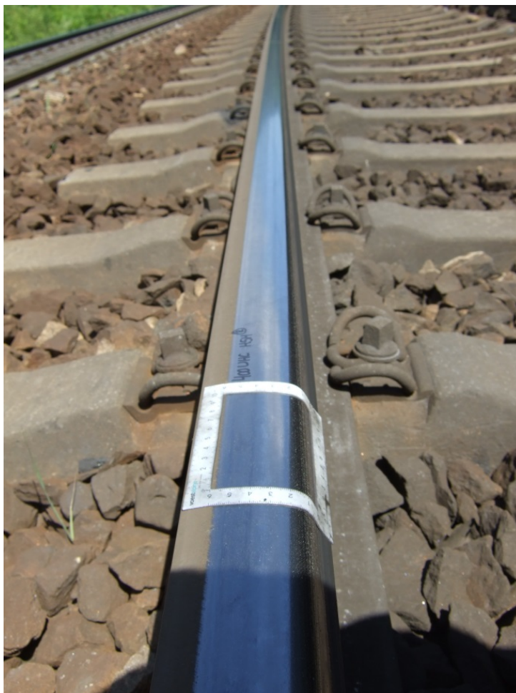
Obr. 1: Zjišťování rozsahu poškození kolejnic
