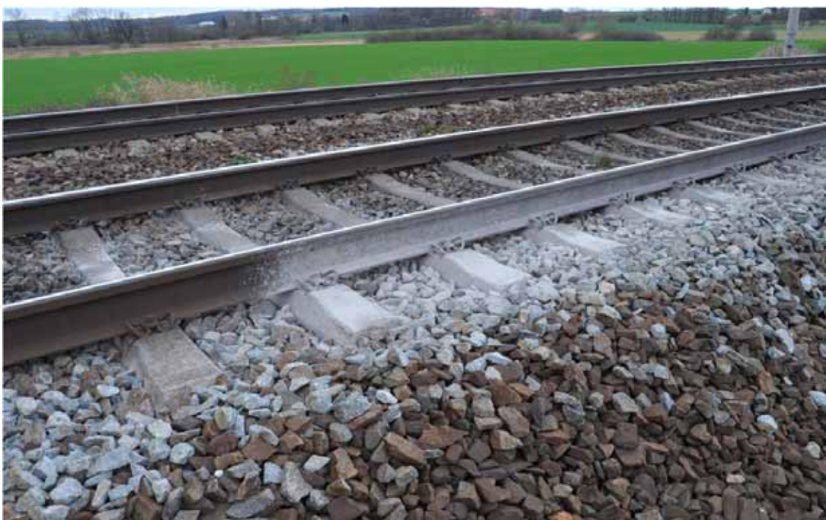
Obr. 5: Blátivé místo na koleji č. 2 velice dobře koresponduje se záznamem georadaru
