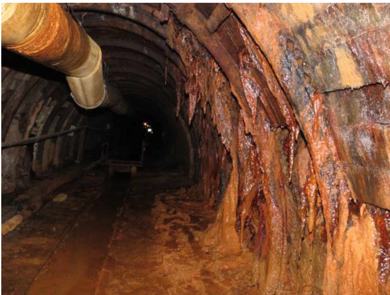
Obr. 11: Průzkumná štola Jezeří u dolu ČSA – intenzivní průsaky podzemní vody v krystaliniku, pravděpodobně podél jedné z dílčích poruch krušnohorské zlomové zóny, rok 2018.
