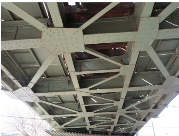
Obr. 3: Porušená PKO na hranách prvků
