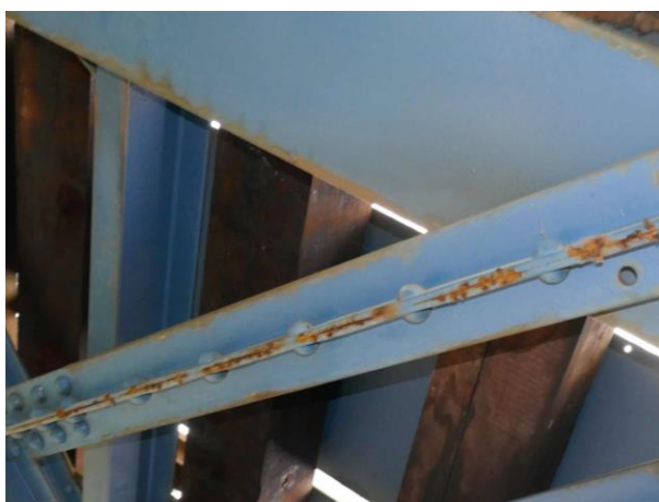
Obr. 8: Štěrbínová koroze Most v km 28,432 trati Libuň – Turnov (č. 2)
