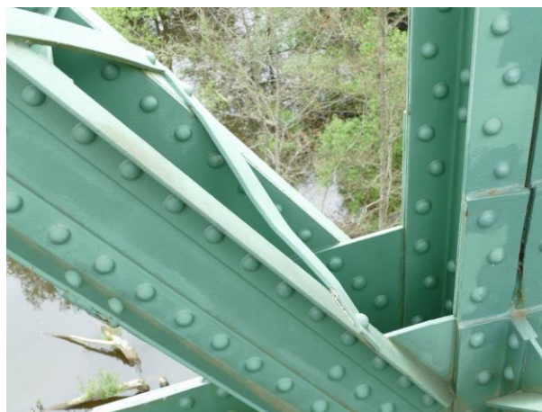
Obr. 2: Deformovaná výztuha diagonály
