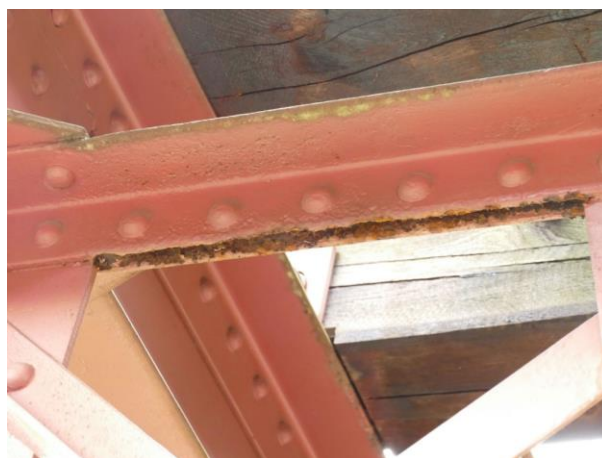
Obr. 4: Koroze ve spáře mezi úhelníky příčnicku
