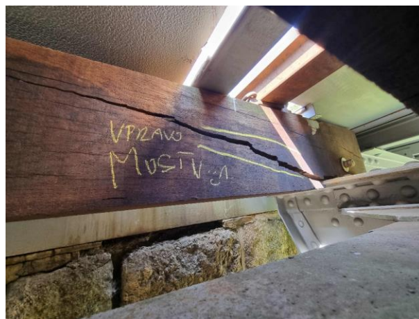
Obr. 2: Podélně prasklá mostnice
