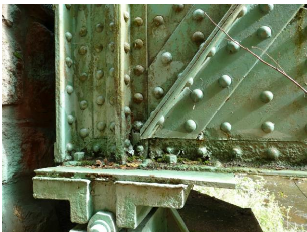
Obr. 1: Korozní oslabení nad ložisky
