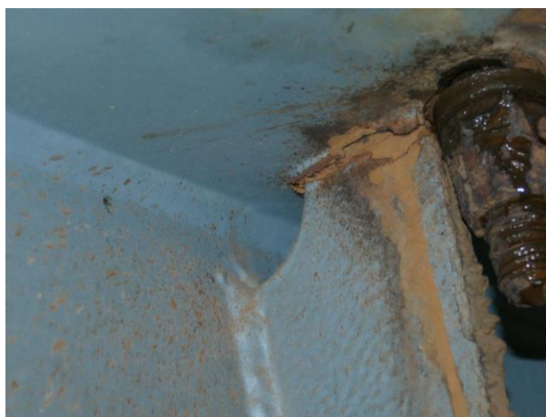
Obr. 12: Trhlina ve svaru výztuhy podélníku Most v km 96,783 trati B. Eisenstein – Plzeň (č. 9)
