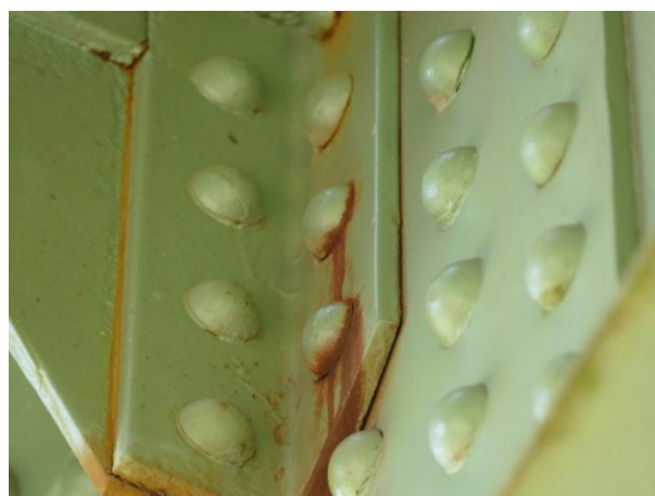
Obr. 16: Uvolněné nýty Most v km 29,557 trati Plzeň – Mladotice (č. 12)
