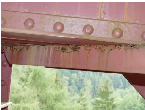
Obr. 3: Porušení PKO na podélném ztužení
