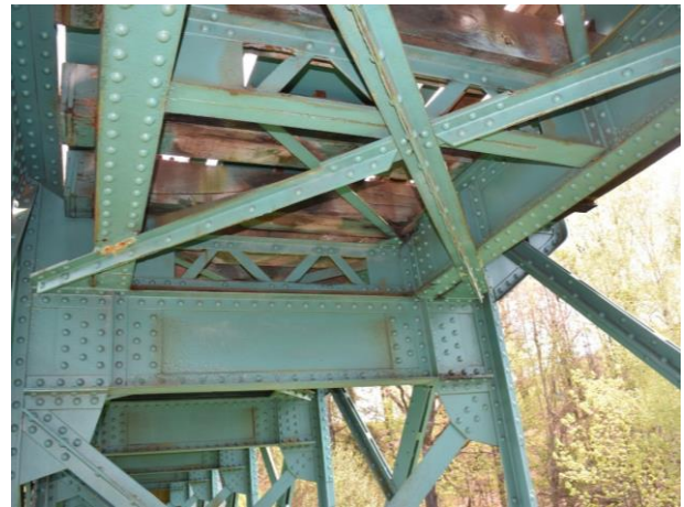
Obr. 2: Šterbinová koroze podélného ztužení
