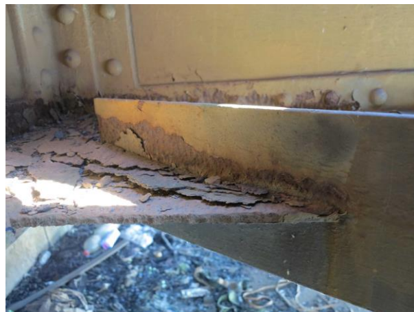
Obr. 4: Plátková koroze styčnickového plechu
