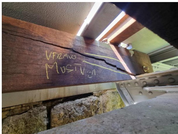
Obr. 19: Podélně prasklé mostnice Most v km 36,628 trati Liberec – S. Poręba (č. 6)
