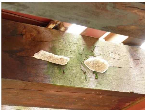
Obr. 20: Mostnice napadené dřevokaznou houbou Most v km 12,061 trati Ejpvovice – Stupno (č. 8)
