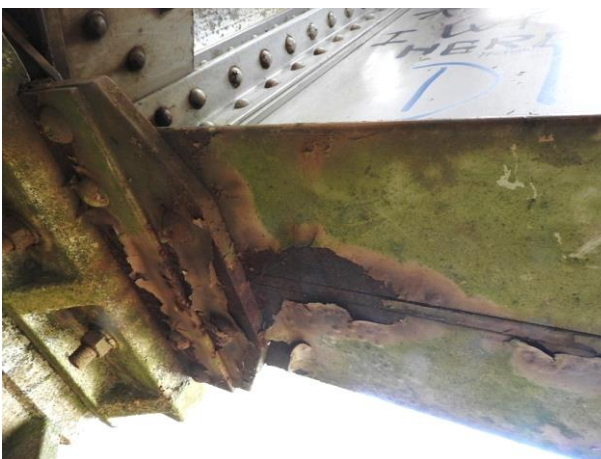
Obr. 3: Odlupování nátěru, znečištění vegetací
