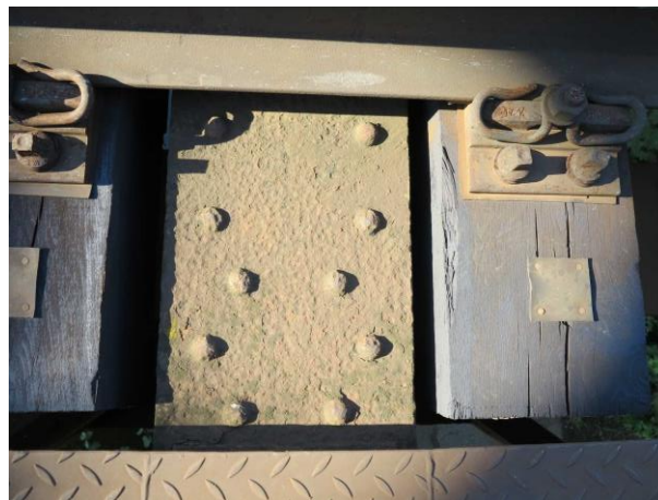
Obr. 2: Korozní oslabení horní pásnice příčnicku
