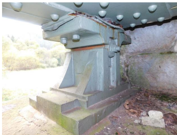
Obr. 4: Postupující koroze nad vahadlem ložiska
