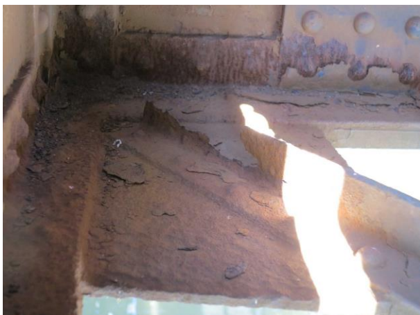
Obr. 3: Korozní oslabení svislé příruby do ostra
