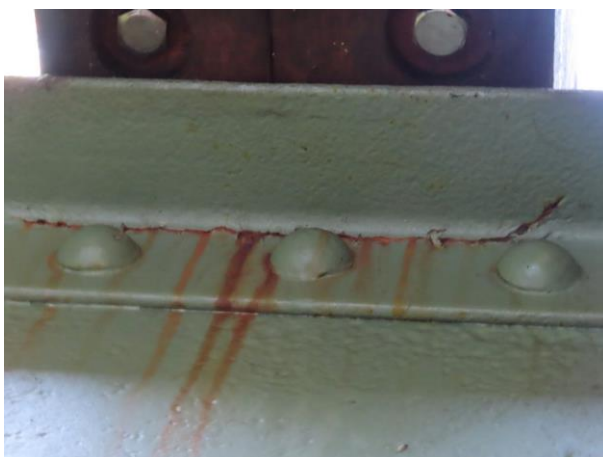
Obr. 1: Trhlina v pasovém úhelníku podélníku
