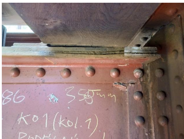
Obr. 11: Trhlina ve svaru horní pásnice podélníku Most v km 16,700 trati Praha – Plzeň (č. 15)
