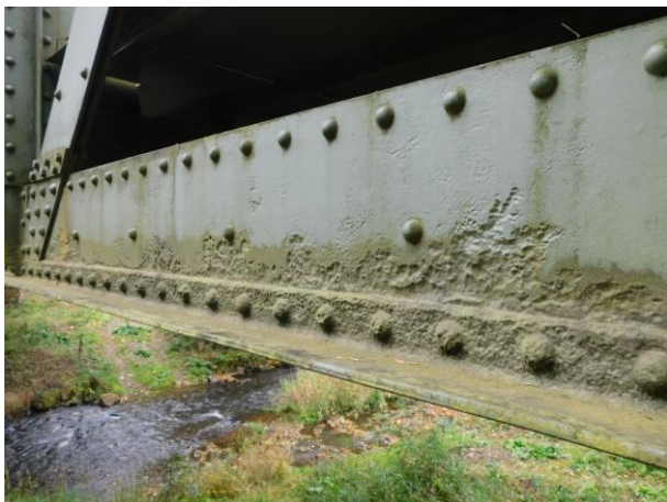
Obr. 1: Korozní oslabení hlavního nosníku
