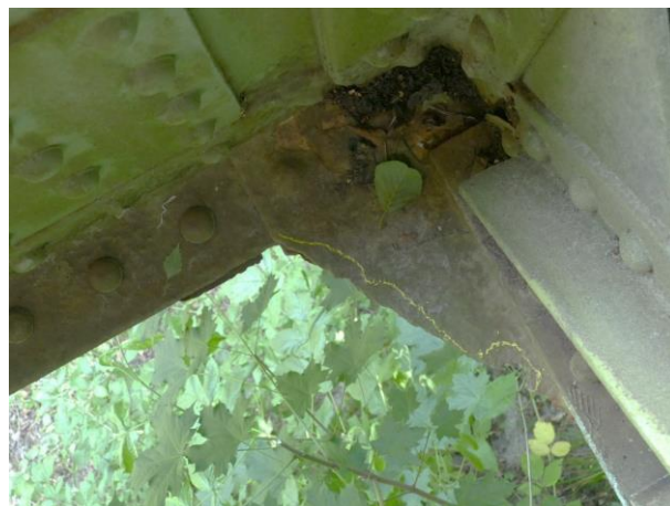
Obr. 2: Oslabení styčnickového plechu do ostra
