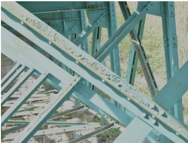
Obr. 1: Korozní oslabení příčného ztužení
