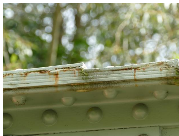
Obr. 4: Štěrbínová koroze mezi plechy pásnic
