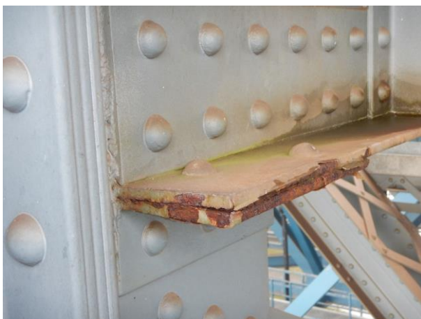
Obr. 3: Štěrbínová koroze ve spárách
