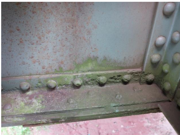
Obr. 1: Oslabení důlkovou korozí, oslabení nýtů
