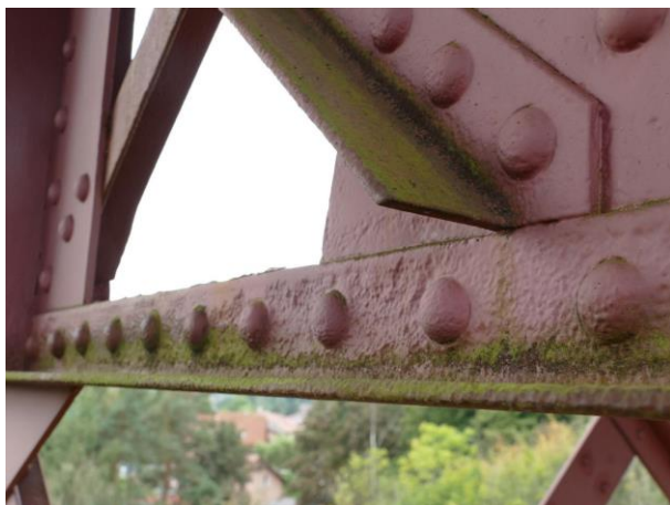
Obr. 1: Korozní oslabení úhelníku příčnicku
