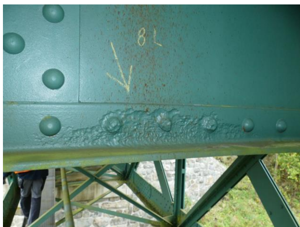
Obr. 1: Korozní oslabení do 4 mm Most v km 29,767 trati M. Lázně – K. Vary (č. 21)
