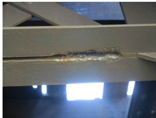
Obr. 2: Oslabení příčného ztužení podélníků
