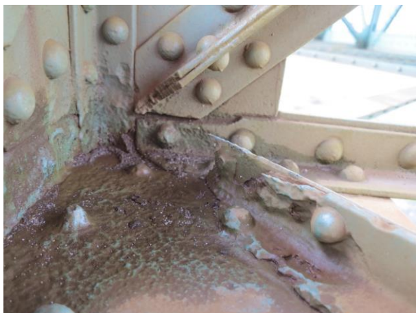
Obr. 1: Oslabení ve styčnicku podélného ztužení
