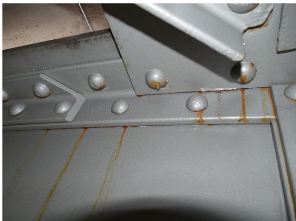
Obr. 1: Netěsné nýty, štěrbinová koroze
