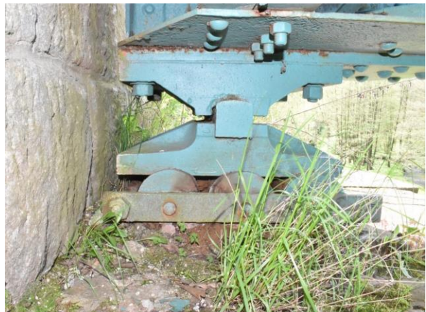
Obr. 4: Posunutá osa valnice, zanesené válce
