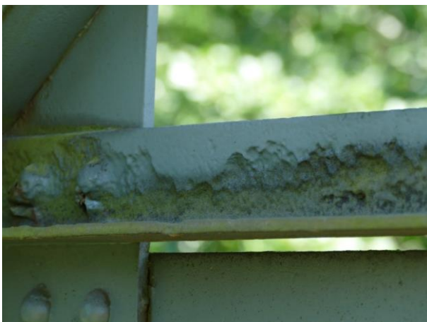
Obr. 1: Lokální korozní oslabení úhelníku
