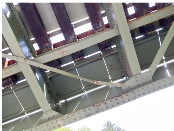
Obr. 17: Zdeformované prvky Most v km 34,321 trati M. Lázně – K. Vary (č. 22)
