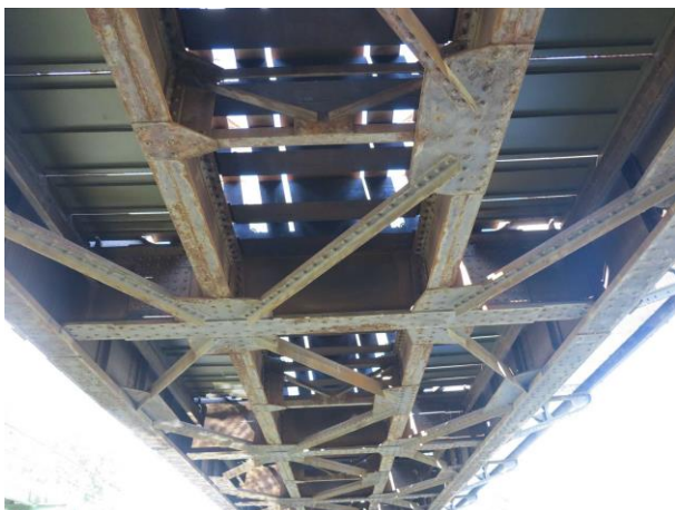
Obr. 1: Porušení PKO, postup koroze
