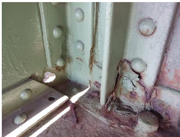
Obr. 2: Degradace nátěru, prokorodování
