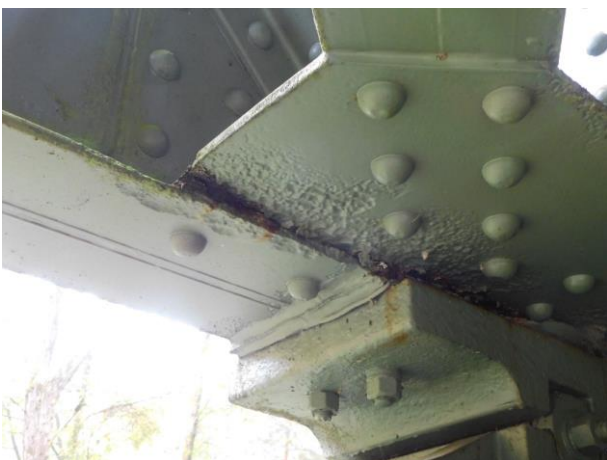
Obr. 3: Korozní oslabení styčnickových plechů
