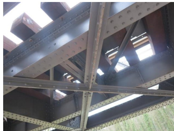
Obr. 4: Poškození nátěru dolního ztužení
