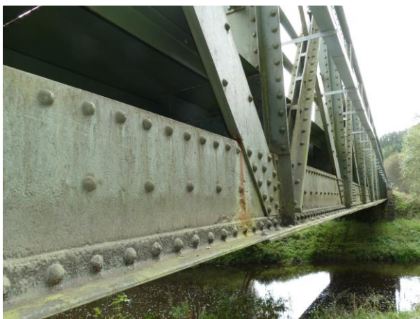
Obr. 1: Korozní oslabení dolních pásů
