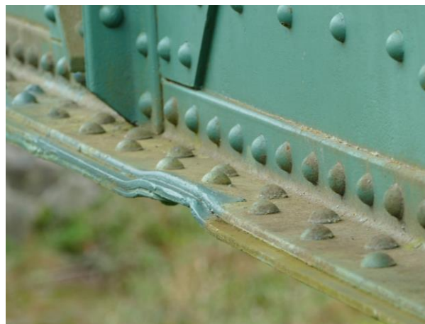
Obr. 2: Deformovaná dolní pásnice hl. nosníku
