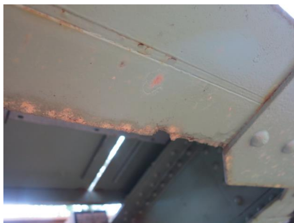
Obr. 3: Korozní oslabení do ostra
