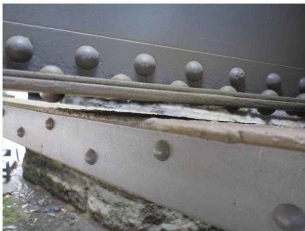
Obr. 3: Oslabení dolního vodorovného ztužení
