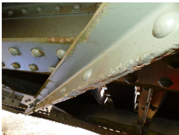
Obr. 4: Štěrbinová koroze na dolním ztužení
