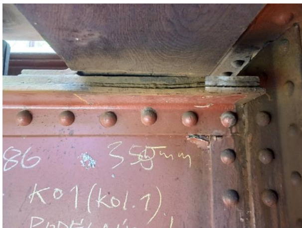
Obr. 1: Trhlina ve svaru pásnice podélníku
