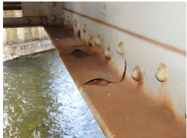
Obr. 2: Odlupování a podkorodování nátěru
