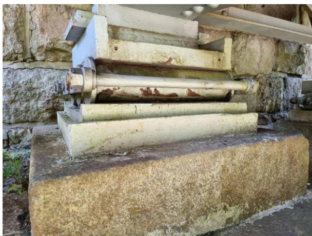
Obr. 1: Lokální poškození PKO na ložisku
