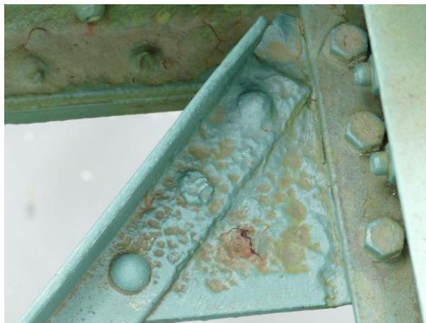
Obr. 4: Odlupování nátěru, korozní oslabení
