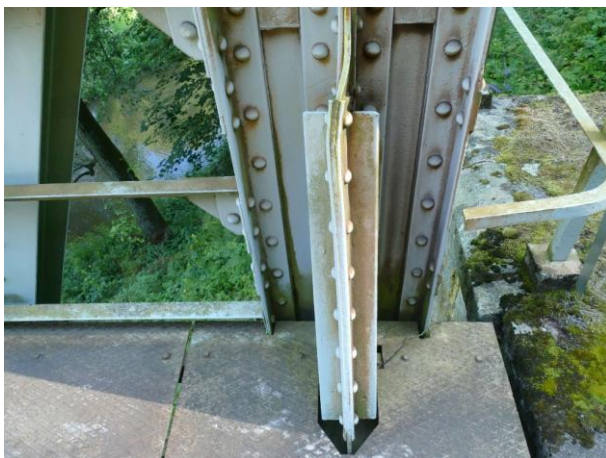
Obr. 1: Deformovaná koutová výztuha
