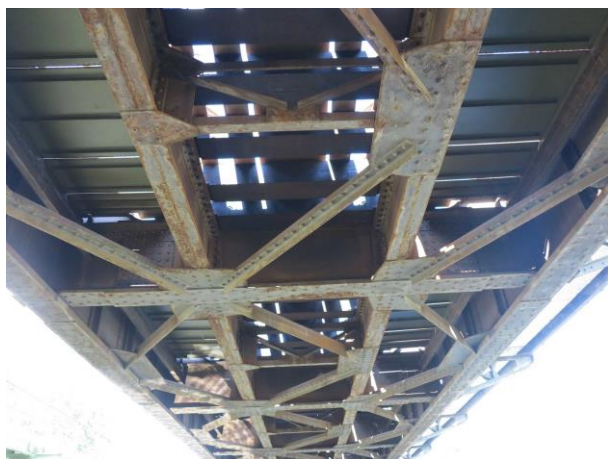
Obr. 5: Stupeň prorezavění Ri 5 Most v km 29,774 trati Chlumeč – Miedz. (č. 3)
