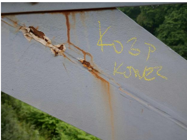
Obr. 1: Poškození nátěru na tmelených spárách
