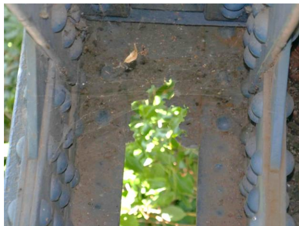
Obr. 2: Korozní oslabení přeplátovacích desek
