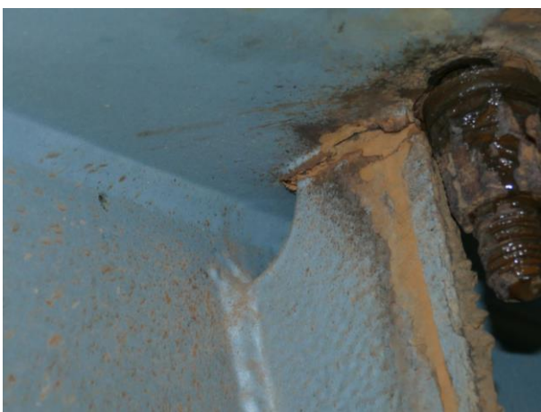
Obr. 1: Trhлина ve svaru výztuhy podélníku
