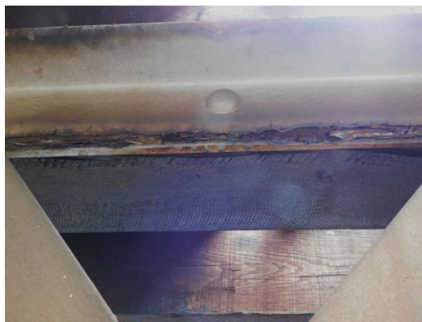
Obr. 4: Spárová koroze úhelníků příčníků
