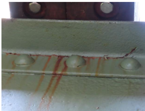
Obr. 10: Trhlina v podélníku Most v km 8,988 trati Martinice – Rokytnice (č. 5)
