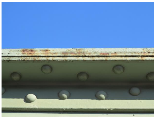
Obr. 4: Štěrbínová koroze pásnice oblouku
