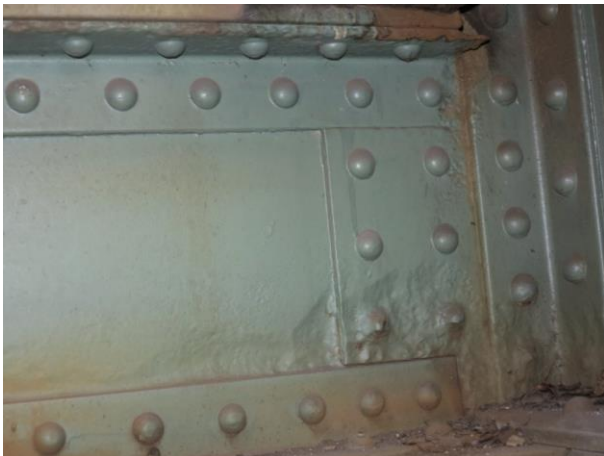
Obr. 1: Korozní oslabení stojiny podélníku
