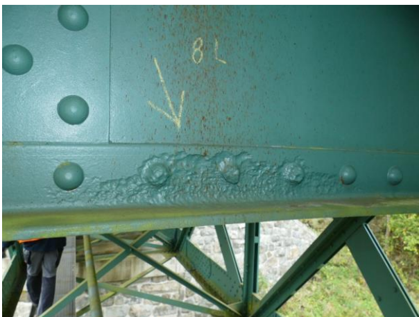
Obr. 1: Korozní oslabení na příčniku
