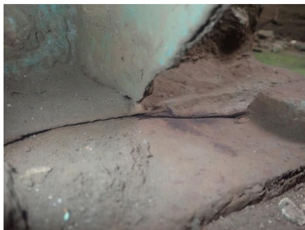
Obr. 2: Nedosedající podružné ložisko
