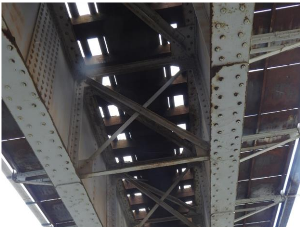
Obr. 1: Celkové prorezavění konstrukce
