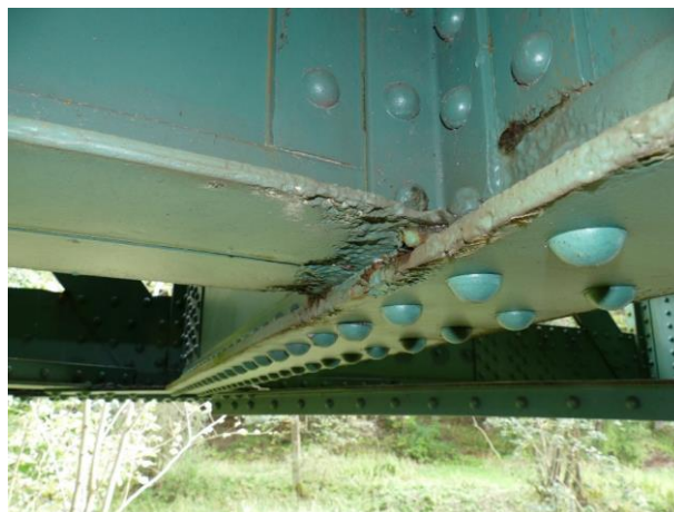
Obr. 2: Koroze v přípoji podélníku na příčnick
