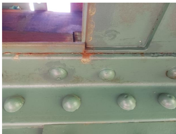
Obr. 4: Štěrbinová koroze na příčniku
