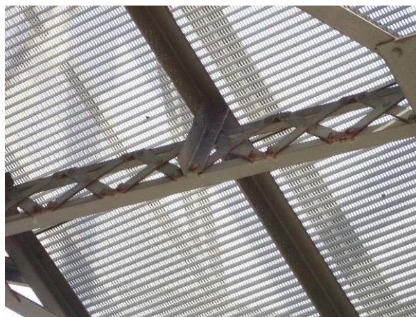
Obr. 2: Netěsné nýtované spoje
