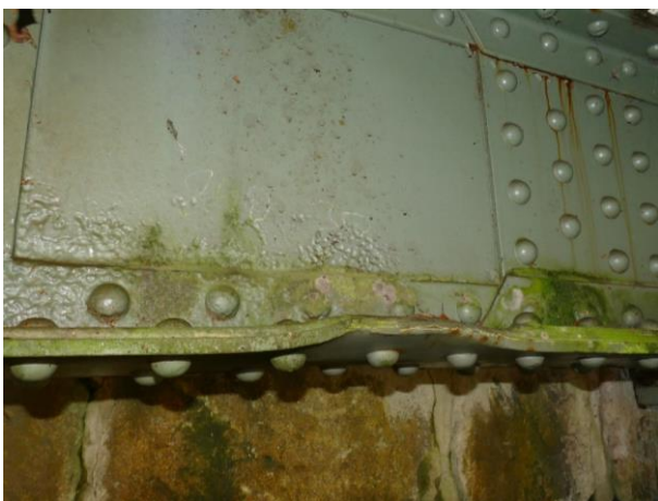
Obr. 1: Korozní oslabení, deformace příčnicku
