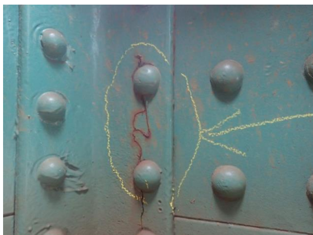
Obr. 9: Trhlina v přípojce podélníku na příčníc Most v km 2,569 trati Brno – Slatinská (č. 1)
