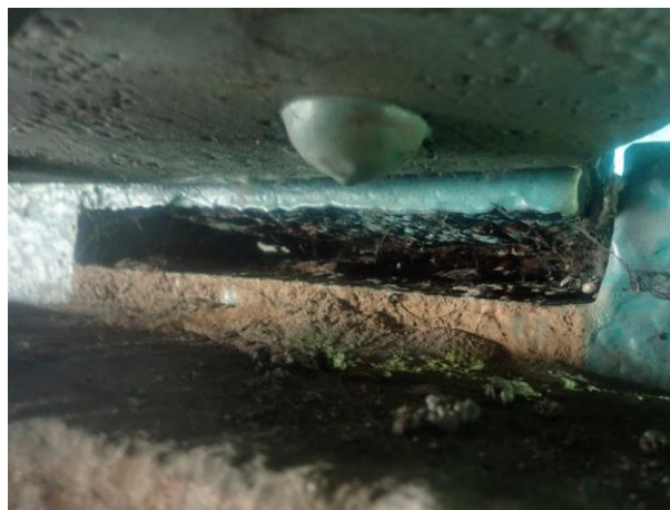
Obr. 2: Korozní oslabení nad ložiskem
