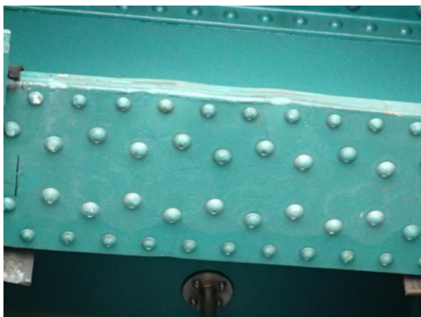
Obr. 1: Deformace dolní pásnice po nárazu
