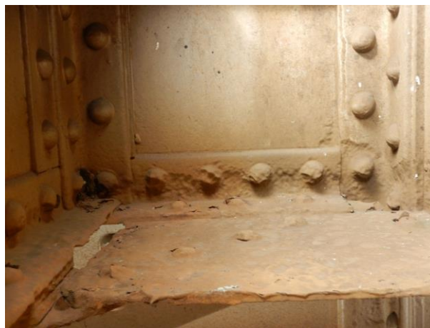
Obr. 2: Korozní oslabení v přípoji ztužení
