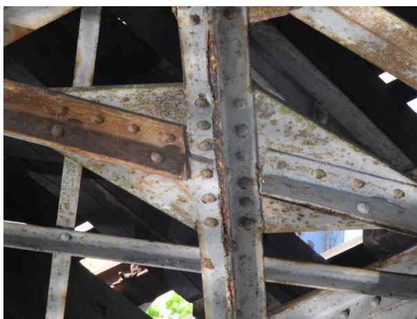
Obr. 2: Štěrbínová koroze mezi úhelníky ztužení
