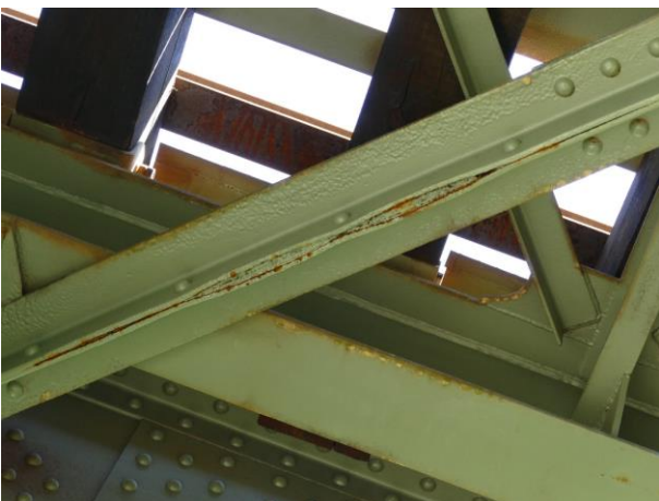
Obr. 3: Koroze ve spáře mezi úhelníky
