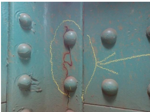
Obr. 1: Trhlina v přípoji podélníku na příčníc
