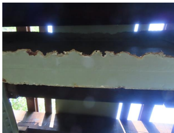
Obr. 4: Korozní oslabení s hranou do ostra Most v km 8,988 trati Martinice – Rokytnice (č. 5)
