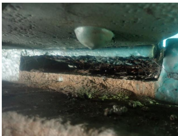
Obr. 2: Korozní oslabení více než 6 mm Most v km 213,710 trati Gmünd – Plzeň (č. 10)
