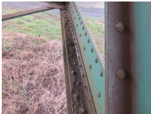
Obr. 2: Korozní oslabení pasového úhelníku
