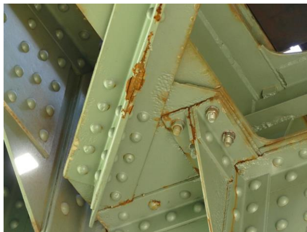
Obr. 2: Porušení PKO, štěrbinová koroze
