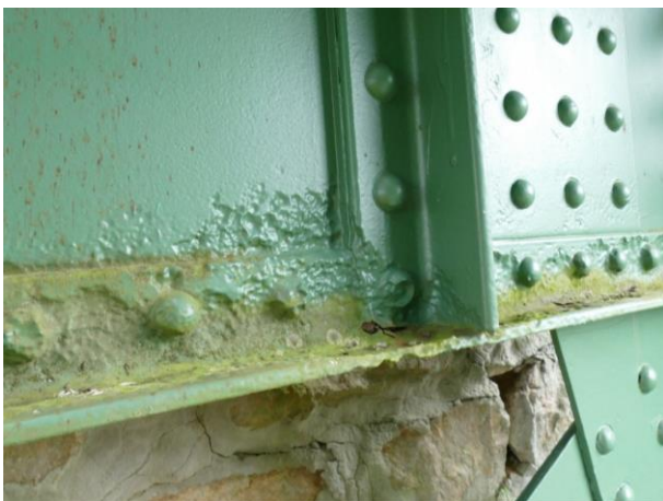
Obr. 1: Korozní oslabení koncového příčnicku
