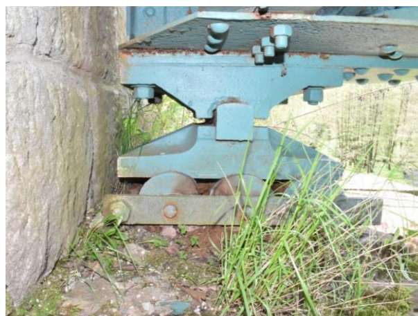
Obr. 14: Zanesení ložisek Most v km 24,627 trati Rumburk – Sebnitz (č. 27)
