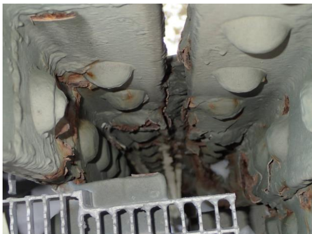
Obr. 1: Porušení PKO, postupující koroze
