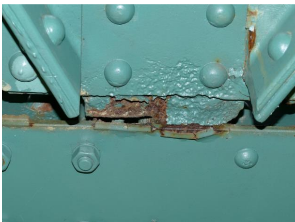
Obr. 3: Koroze v přípoji příčnicku na hl. nosník
