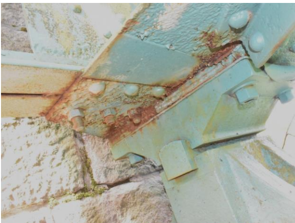
Obr. 3: Postupující koroze nadložiskové desky
