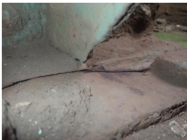
Obr. 15: Nedosedání podružných ložisek Most v km 2,569 trati Brno – Slatinská (č. 1)
