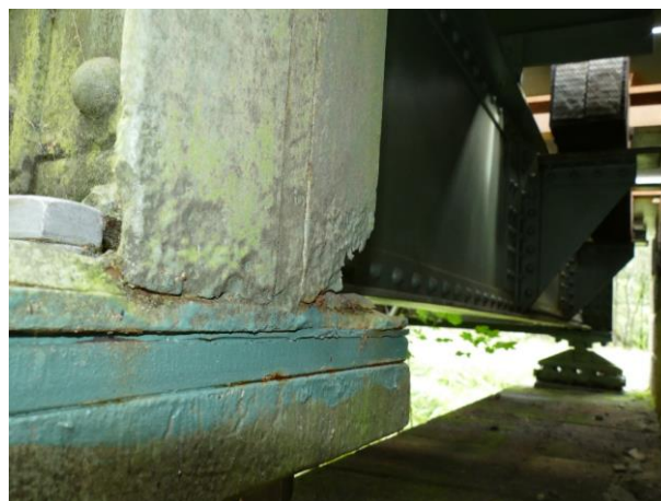
Obr. 2: Korozní oslabení koncových úhelníků
