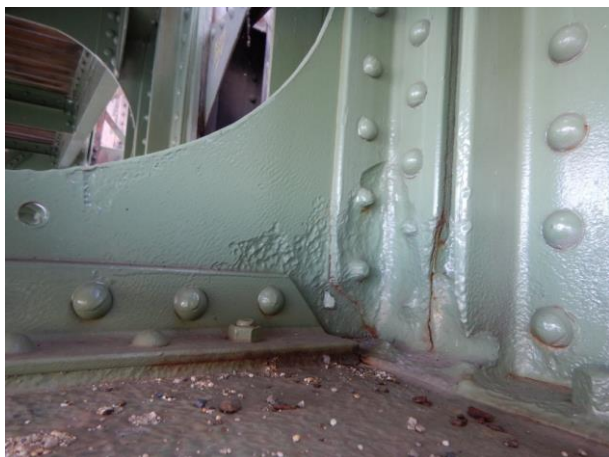
Obr. 1: Korozní oslabení, štěrbinová korozí
