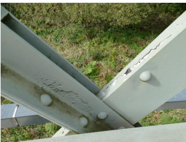
Obr. 3: Degradace tmelených spár diagonál
