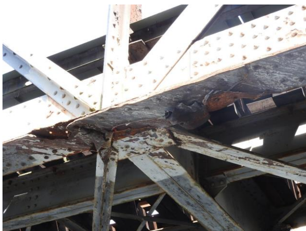
Obr. 1: Deformovaná pásnice hlavního nosníku
