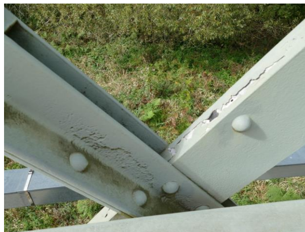
Obr. 6: Degradace tmelených spár Most v km 44,222 trati M. Lázně – K. Vary (č. 25)
