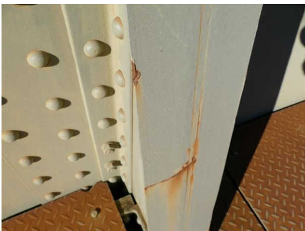
Obr. 3: Vrypy a rýhy na koutové výztuze
