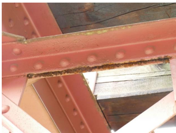
Obr. 7: Spárová koroze Most v km 12,061 trati Ejpvovice – Stupno (č. 8)
