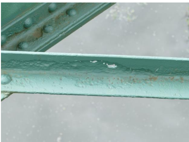
Obr. 3: Prokorodovaný úhelník dolního ztužení
