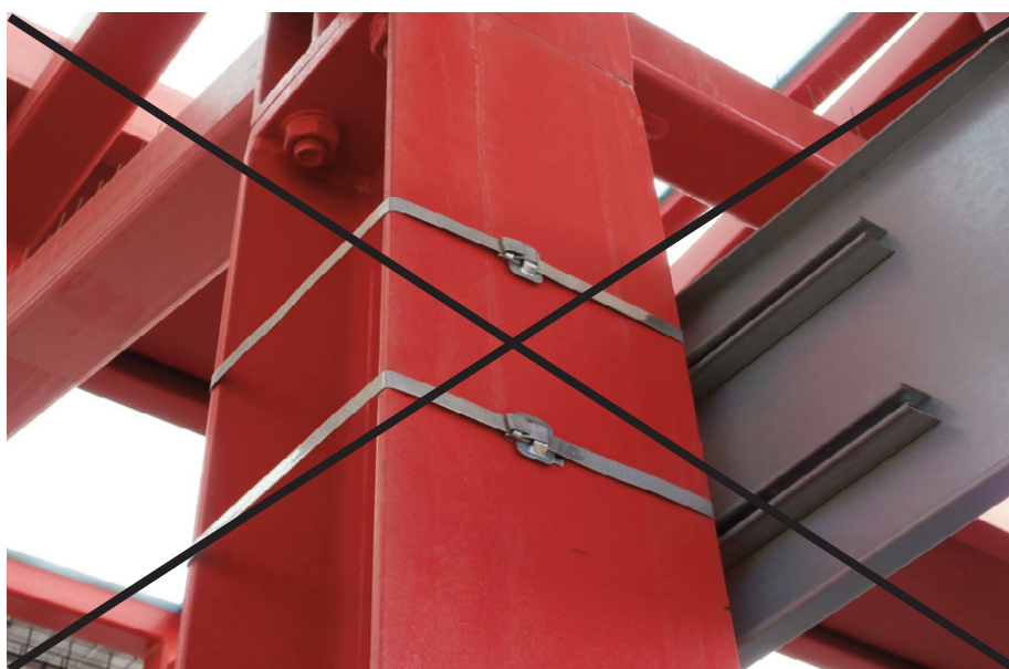
Příklad nevhodného uchycení – pásy poškozují protikorozní ochranu sloupu.
